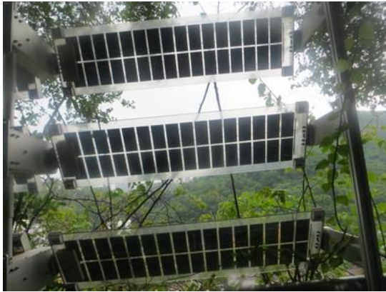
◆屋面光伏板（按照太阳辐射强度）
